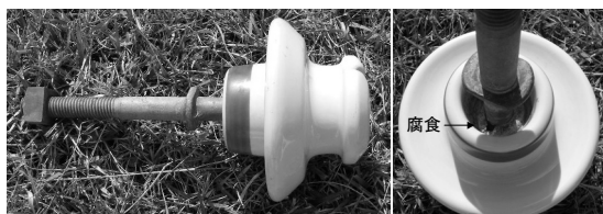
(b) 腐食したがいし
